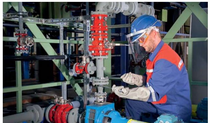
↑ Installation einer DIABON® Graphitpumpe
